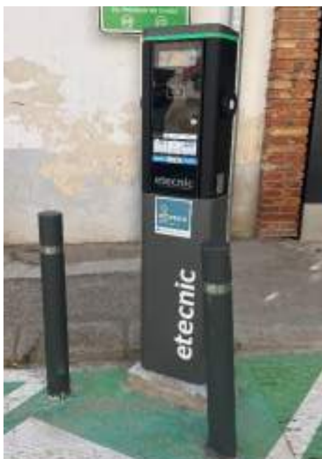
Il·lustració 47.- Punt de recàrrega elèctric de Soses
